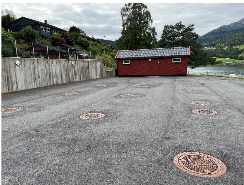
Figur 5 Slamavskiljar ved Hjeltnes ble etablert i 2018. Slamavskiljaren er dimensjonert for 2000 pe.
