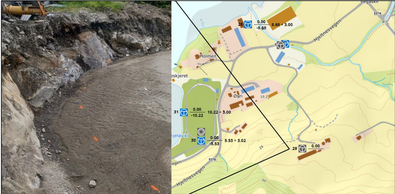
Figur 5-3: Bilete som viser at det er grunt til berg i opphavlege planlagte posisjon 29.
