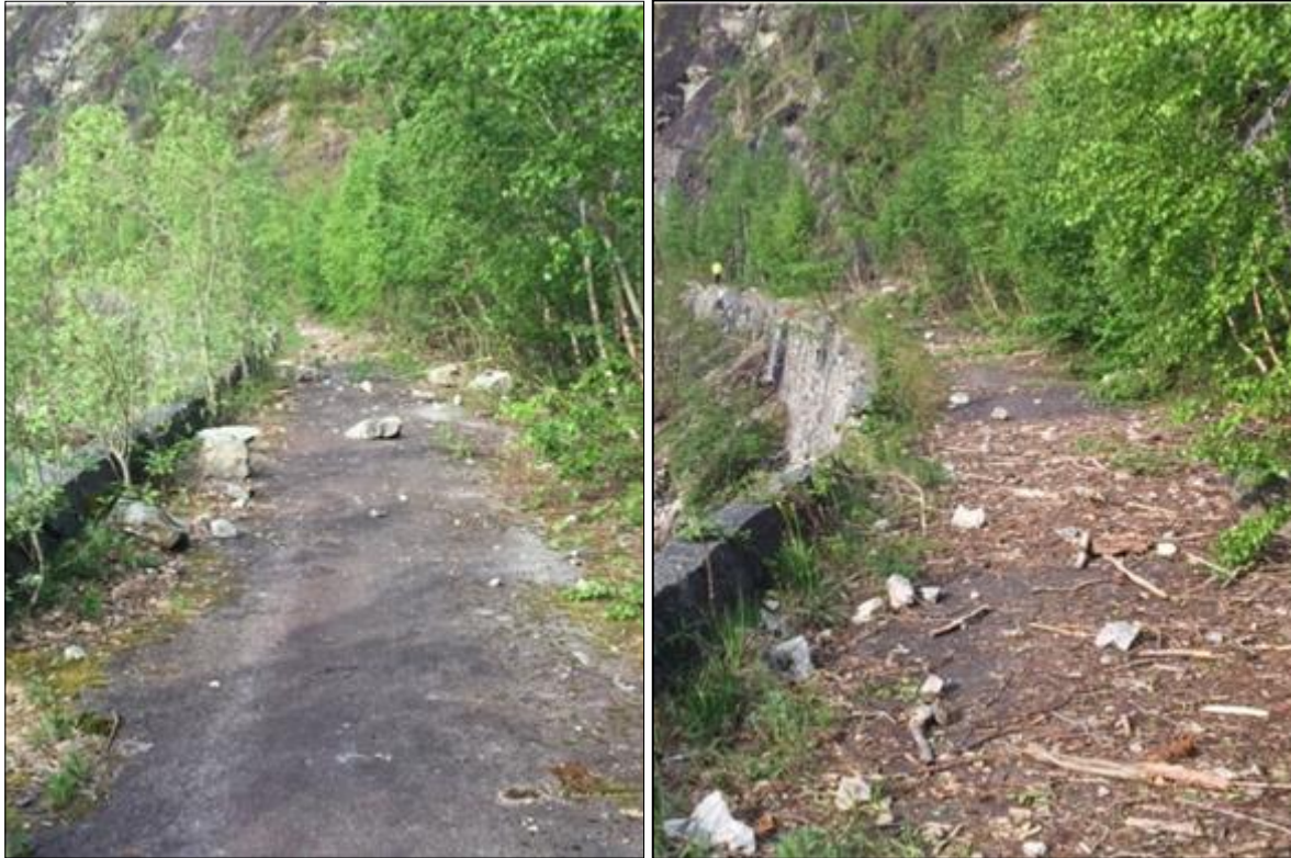
Figur 6. Tilstanden på gamlevegen like ved krysset til fylkesvegen nær Ryggsnes (aust). FOTO: privat
